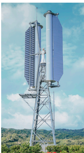
フィリピンに設置した垂直軸型 マグナス式風力発電 10kW機
